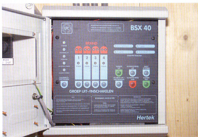
Afbeelding 4.3 voorbeeld van een brandmeldinstallatie
